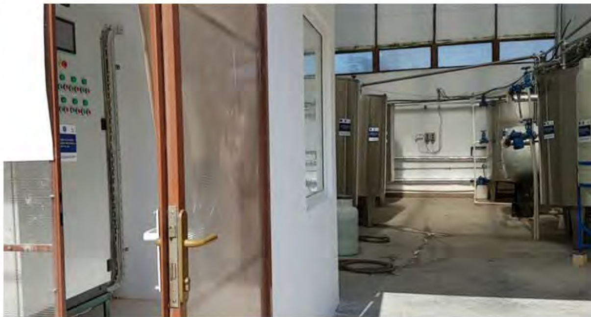
Fig. 6.11. Vedere de ansamblu a instalației destinată microproducției de fluide ecologice.
